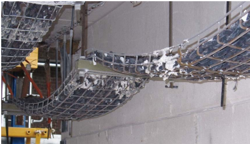
Bild 2: Verformte Gitterrinne nach der Brandprüfung
